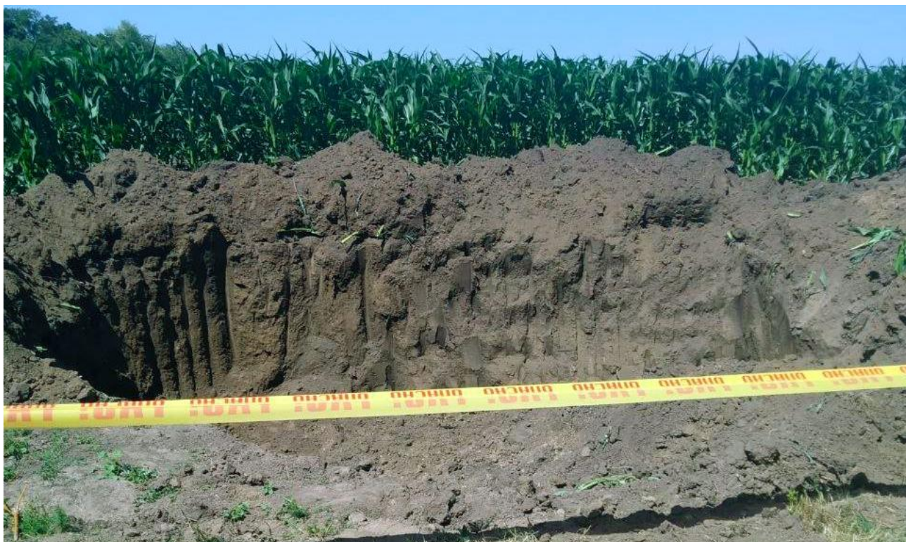
Рис. 1.15. Земельні роботи, що призвели до пошкодження трубопроводу [37]
