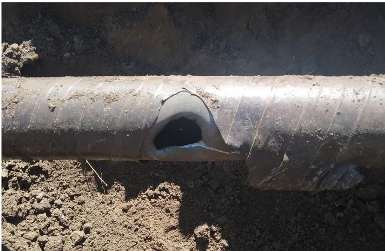
Рис. 1.16. Пошкоджений технікою трубопровід [36]
