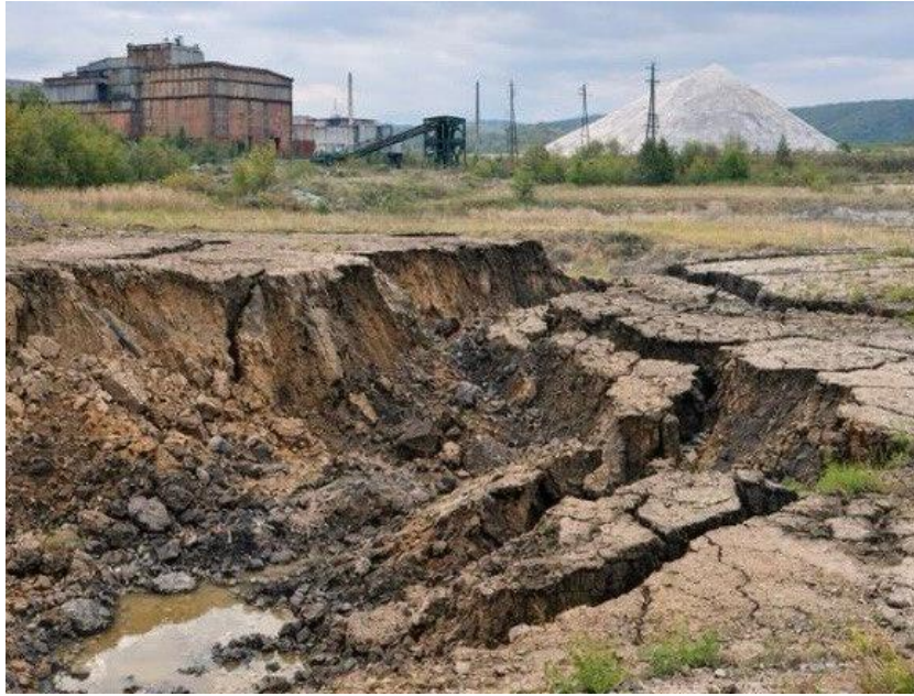
Рисунок 3.2 – Просідання ґрунту в зоні рекультивованих хвостосховищ калійного виробництва поблизу м. Калуш
